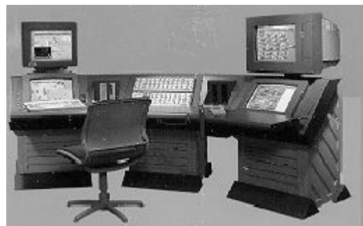
Fig. 17.8. Console de computador de um sistema digital de controle distribuído
